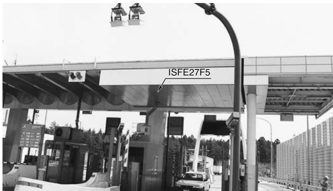
電波環境をより良い環境に整備するためにETC（自動料金収受システム）に取り付けられたETC用電波吸収パネル例（ISFE27F5を使用）
